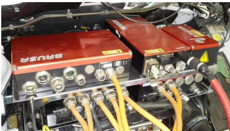
شکل ۷-۱۵ جانمایی تجهیزات برقی در محفظه موتور
